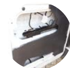
Binnenbekleding zwaar beschadigd of ontbreekt
